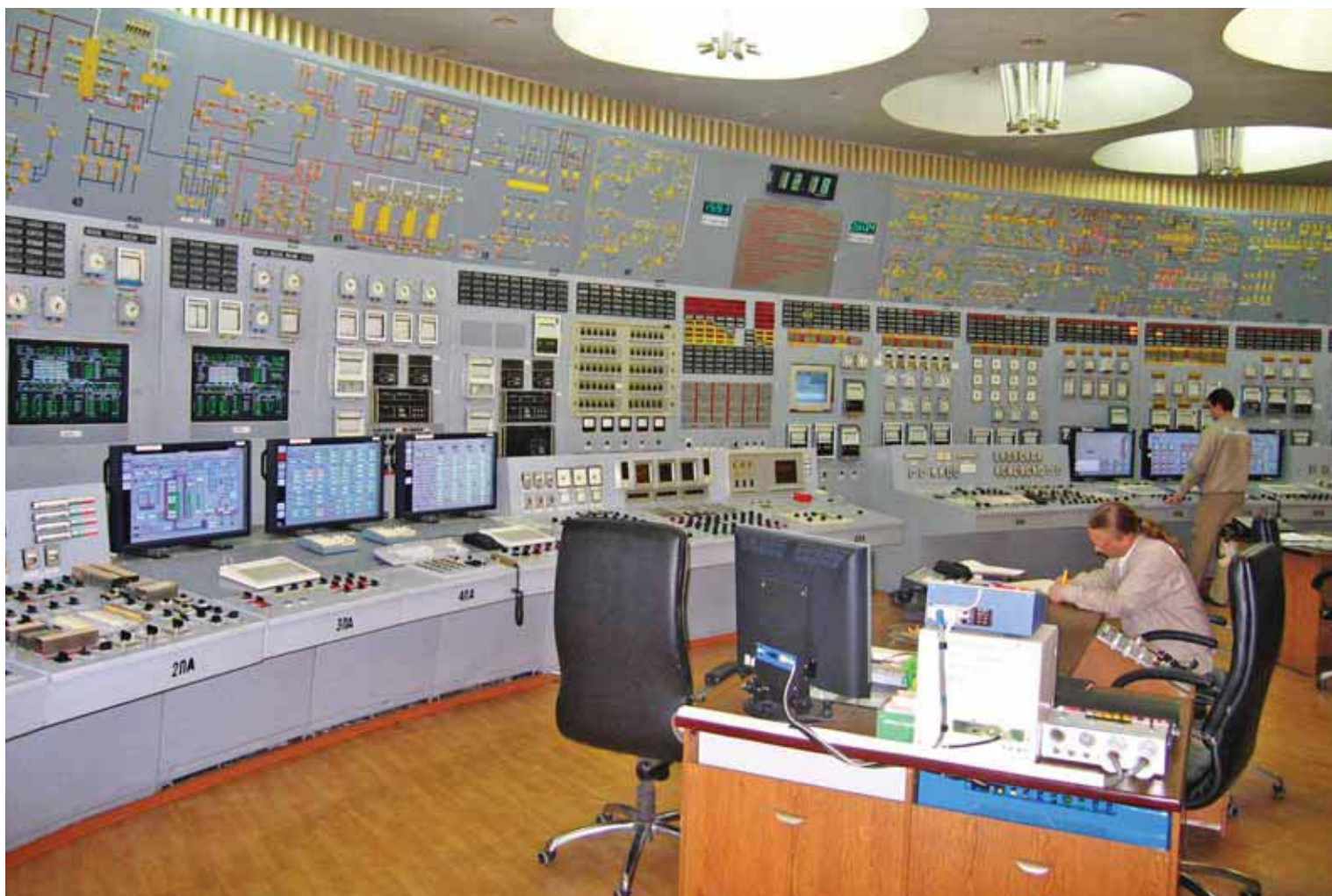
БЩУ энергоблока ЮАЭС после реконструкции ИВС
