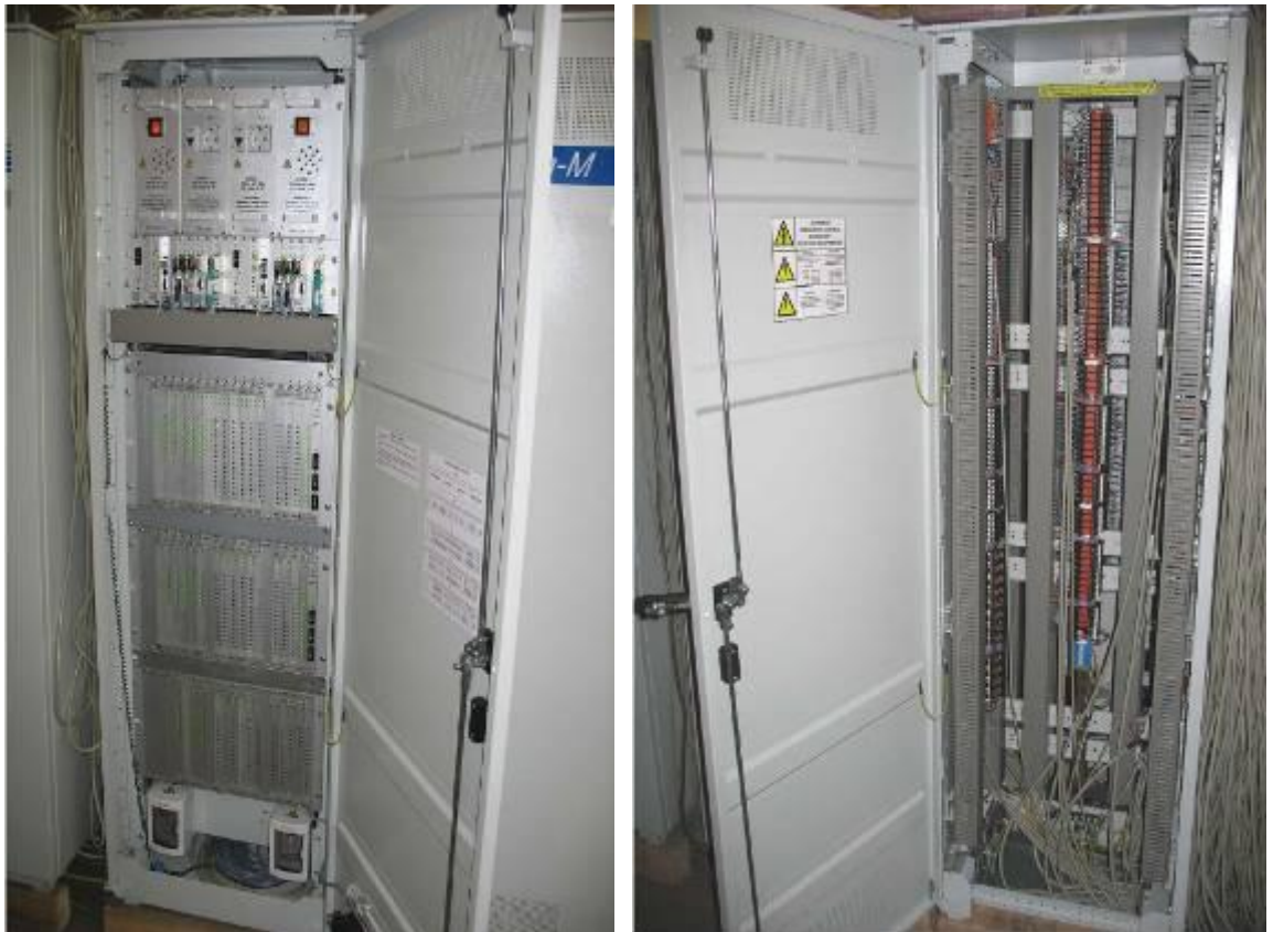
Рис. 4. СКСО и релейный шкаф ПТК
